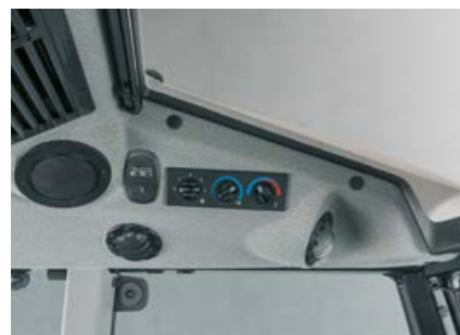
Le système de chauffage et de ventilation intègre un ventilateur à quatre vitesses et de nombreuses buses de ventilation réglables. Une climatisation réglable est également disponible.
