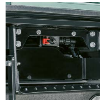
Le coupe-batterie est installé à portée de main au niveau du marchepied gauche.
